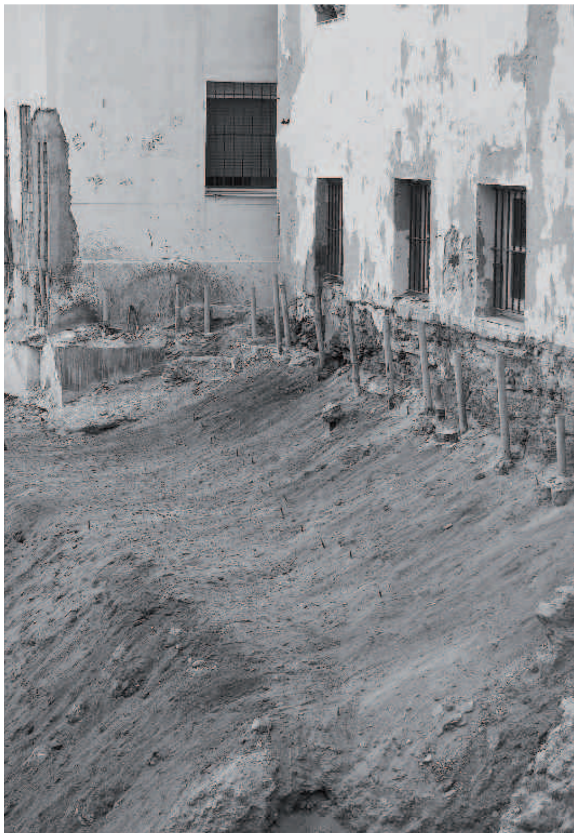
Figura 24. Vista lateral de la berma, apoyada sobre la cimentación de las edificaciones objeto de consolidación, desde el sur
