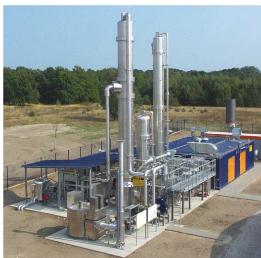
Figura I.5 Instalación de absorción con solventes orgánicos para purificación de biogás en Suecia. Capacidad de 1100 \text{ Nm}^3 \text{ h}^{-1} . Imagen de Haase Energietechnik [27].
