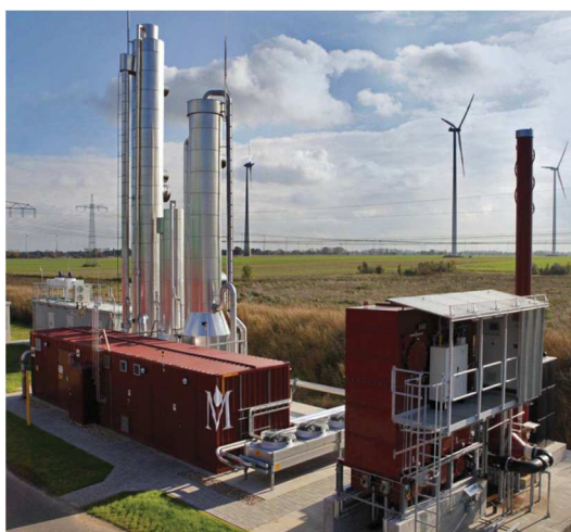
Figura 1.4 Planta de absorción física con agua para purificación de biogás en Nauen (Alemania). Capacidad: 1250 \text{Nm}^3 \text{ h}^{-1} . Imagen de Malmberg Water [28].
