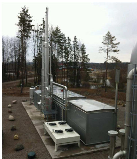
Figura 1.6 Instalación de absorción química para purificación de biogás en Suecia. Imagen de Purac Puregas [27].
