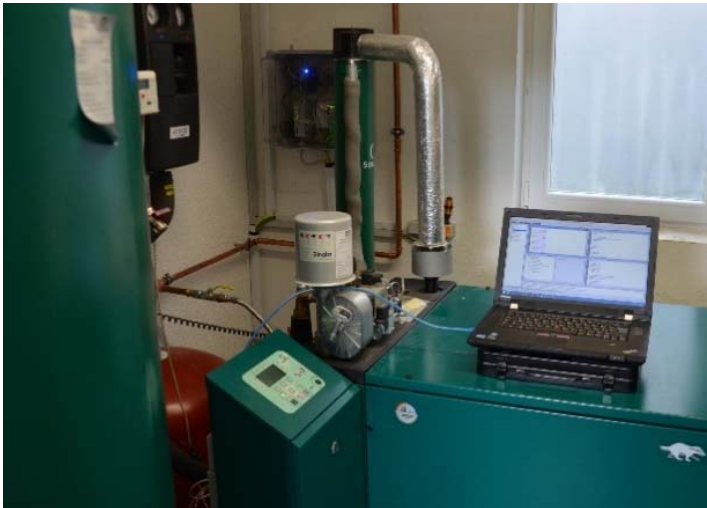
Abbildung 5-2: BHKW der Feldtestanlage 2 mit Wärmespeicher, Steuerungsbox und PC
