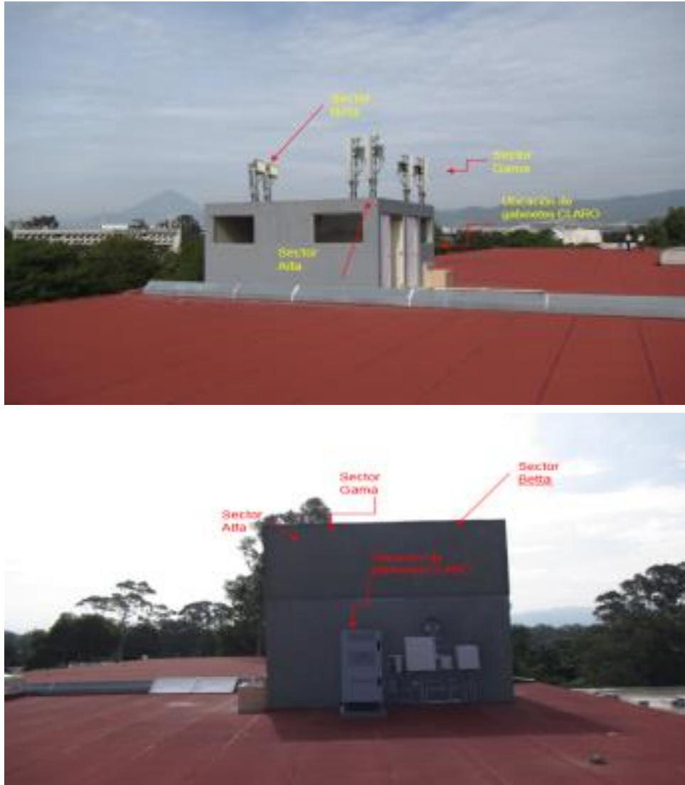
Figura 86. Solución Azotea (Roof Top) T3 mimetizada
