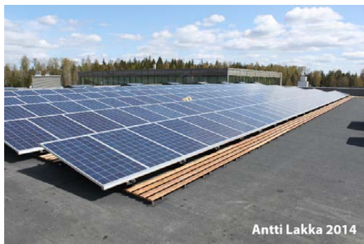
Kuva 5 Vuores-talon aurinkosähköjärjestelmä (Tampere)
