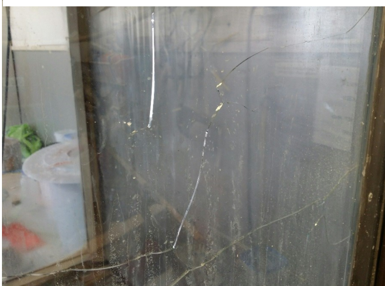
Kuva 18 Hiomakopin lasiseinään tuli halkeamia sinkoilevista lasinsiruista
