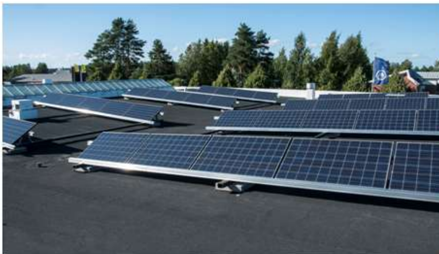
Kuva 8. Aurinkosähköpaneelit katolla (Nurmijärven Sähkö Oy, verkkokuva)
