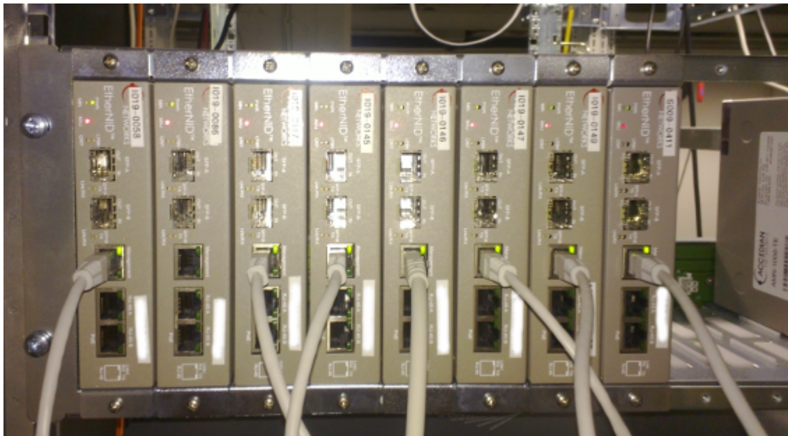
Kuva 21: Useita Accedian Ethernetid GE -demarkaatiolaitteita niille tarkoitetulla rakkiihlyllyllä.
