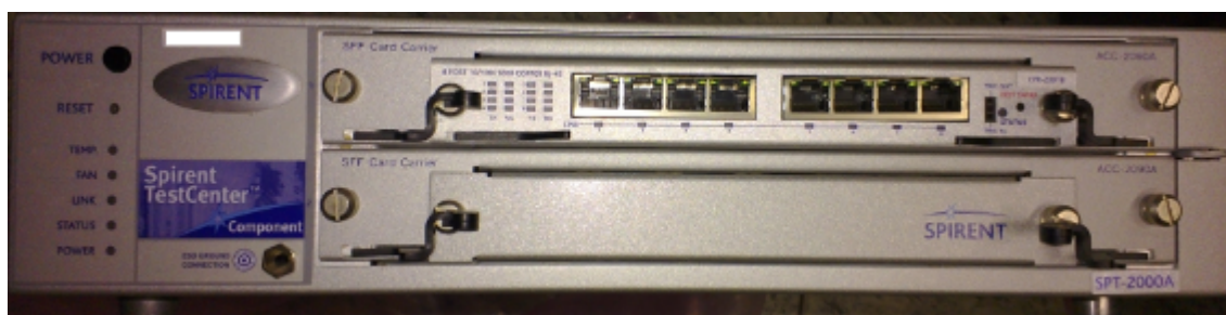
Kuva 18: Spirent Testcenter -liikenneanalyysointilaitteita yhdellä linjakortilla.
