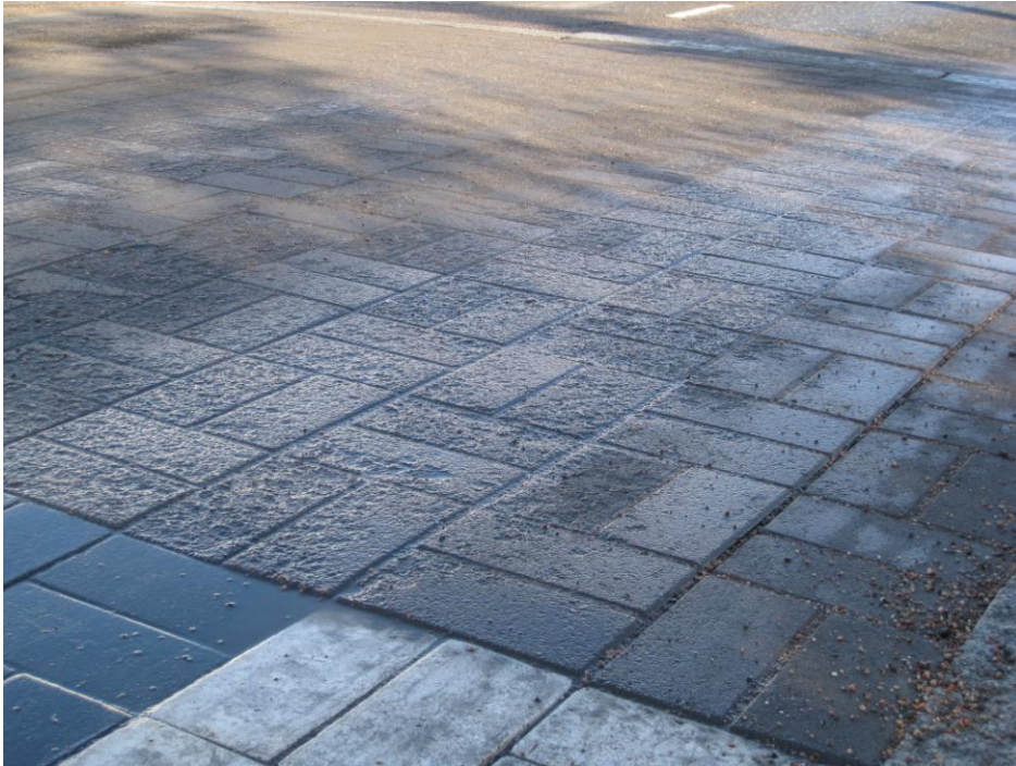
Kuva 39 Kuluneita betonikiviä. Kuva otettu 23.3.2012.
