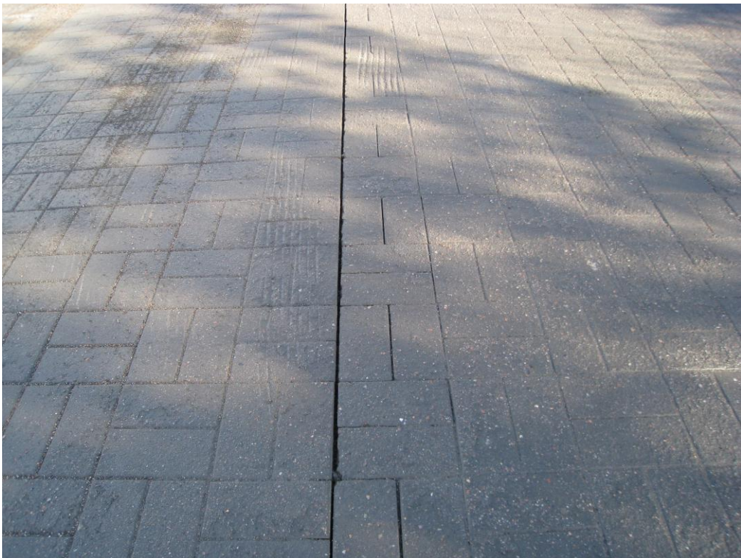
Kuva 40 Rako ajoradan keskilinjalla. Kuva otettu 23.3.2012.
