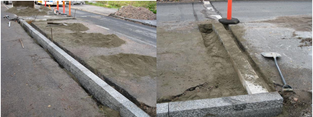
Vasen: reunakivet asennetaan maakostean betonin varaan. Oikea: lopuksi laatikko täytetään maakostealla betonilla.
