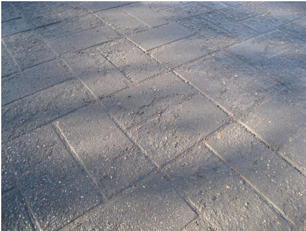
Betonikivien kulunutta pintaa.
