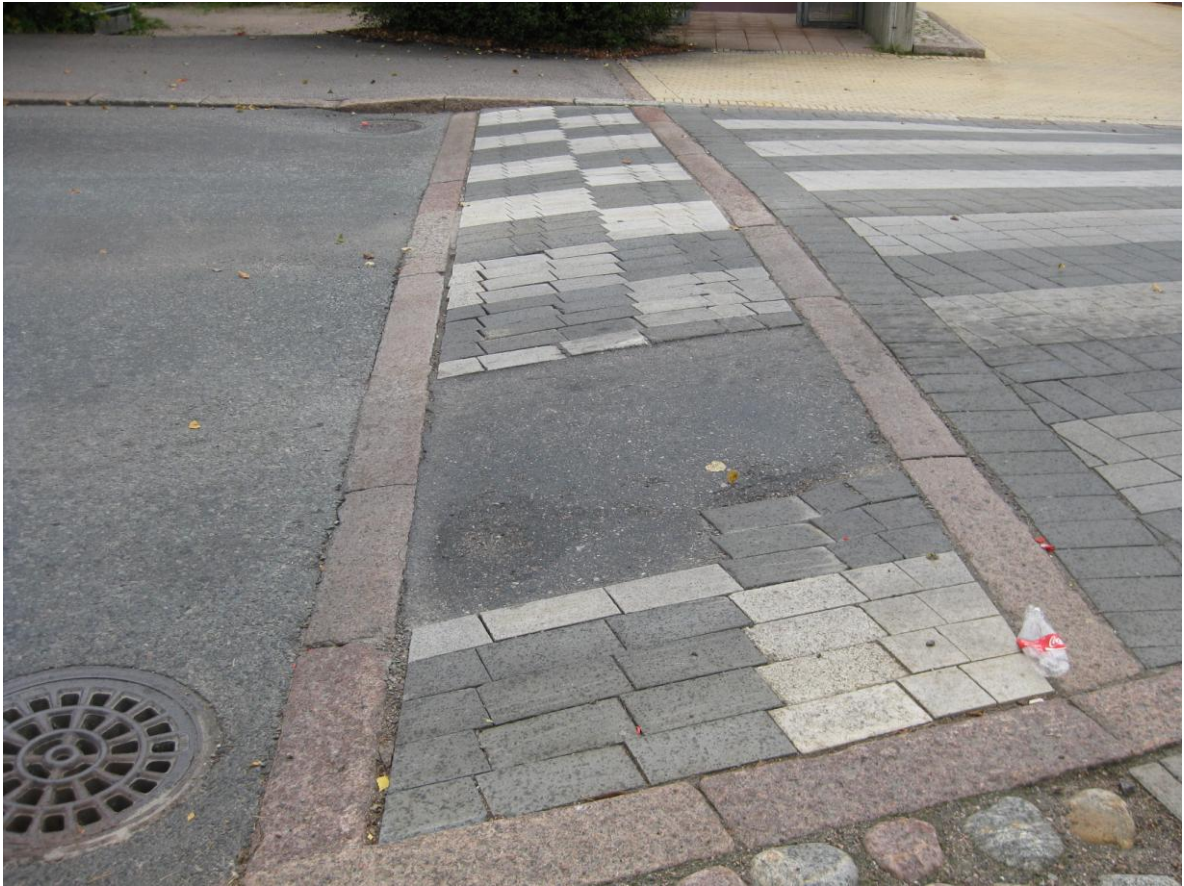
Liite 8 Keravan Asemantien Ekokivipäällysteen vaurioita
