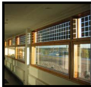
Kuva 25. NCC:n pääkonttorin lasisiin integroidut aurinkokennot. [20]
