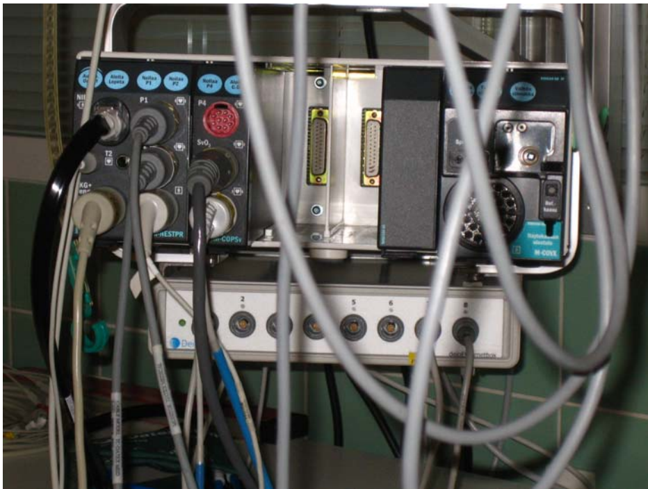
Kuva 23. Tämän päivän sairaalan mittaus- ja valvontalaitteistot sisältävät runsaasti johtoja.
