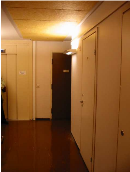
Kuva 14. Käytävän uusi valaistus. Käytävässä on käytetty kolmea kappaletta 2*55W epäsuoria seinävalaisimia.
