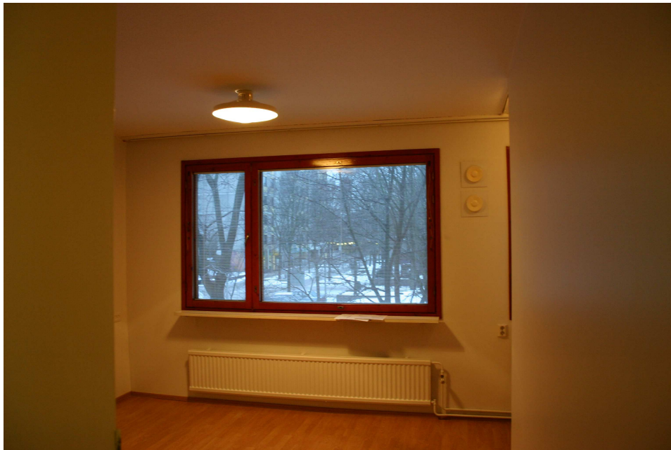
Kuva 6. Asuinhuoneen olohuoneen valaistusvoimakkuus ei ole riittävä. Katto ja seinät ovat hämärät.
