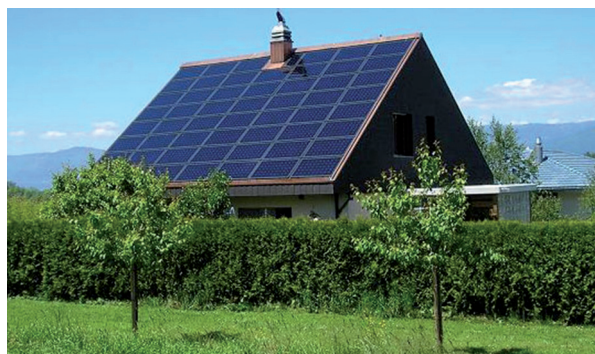
Módulos de paneles solares en el techo de residencias para alimentarlas con energía eléctrica foto-generada a partir de la radiación solar.
