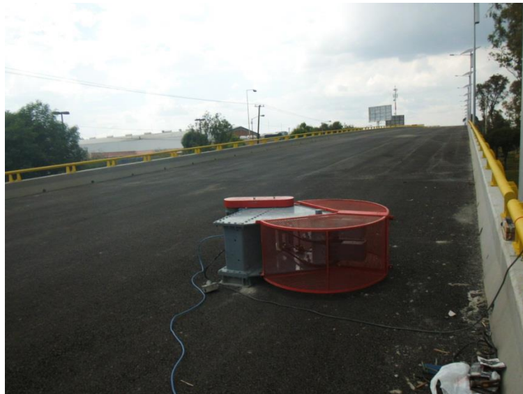
Figura 4.2.6 Excitador de masas excéntricas anclado a la losa del puente
