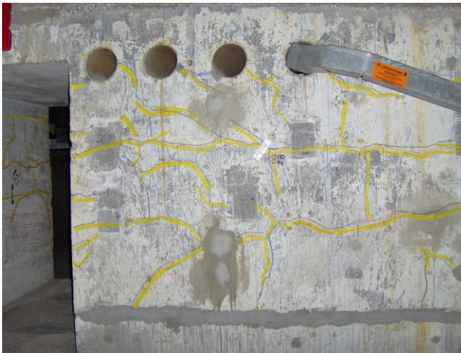
Figura I.4. Agrietamientos observados en una de las pilas del Puente (en el interior de la calzada), en visita realizada en agosto de 2007.
