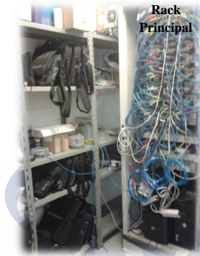
Figura 69. Instantánea del cuarto de comunicaciones Fuente: Diario de Campo de la Investigadora
