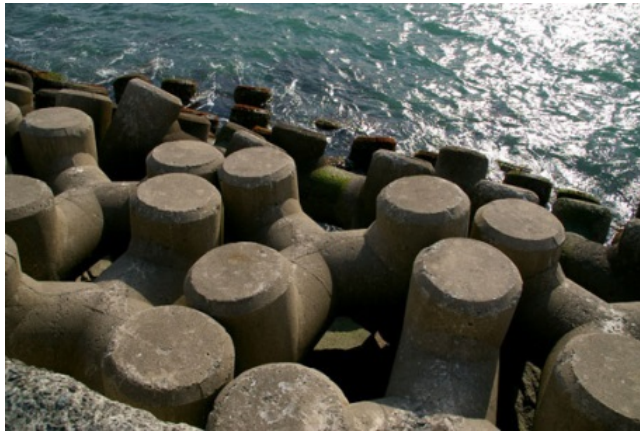
Figura 2- 6 Manto Tribar en un dique en talud de Japón
