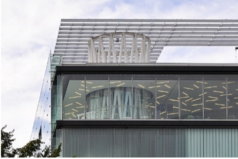
Fig. 152 Apertura superior tubos – ventilación natural
