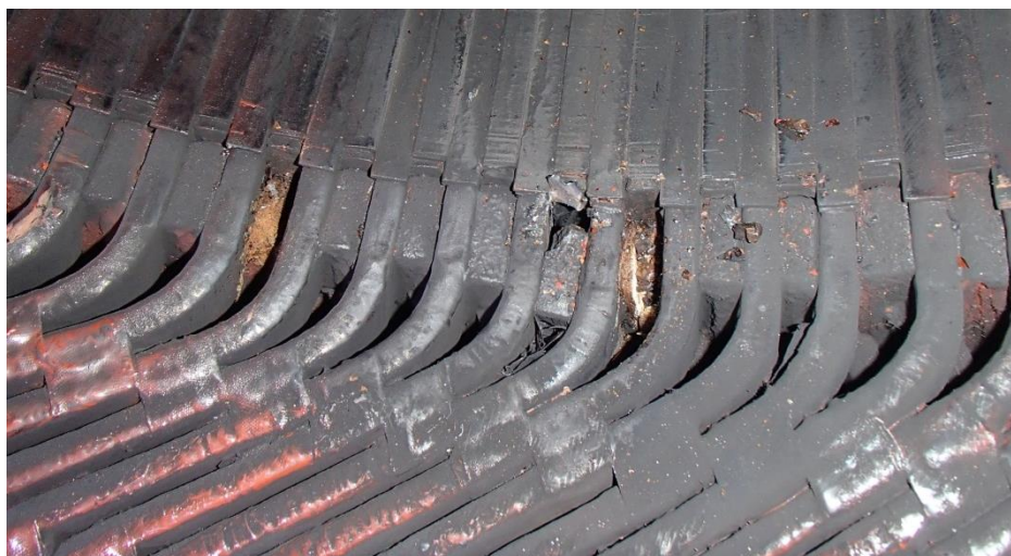
Figura A.8. Constatação dos danos ao final da chaparia do estator
