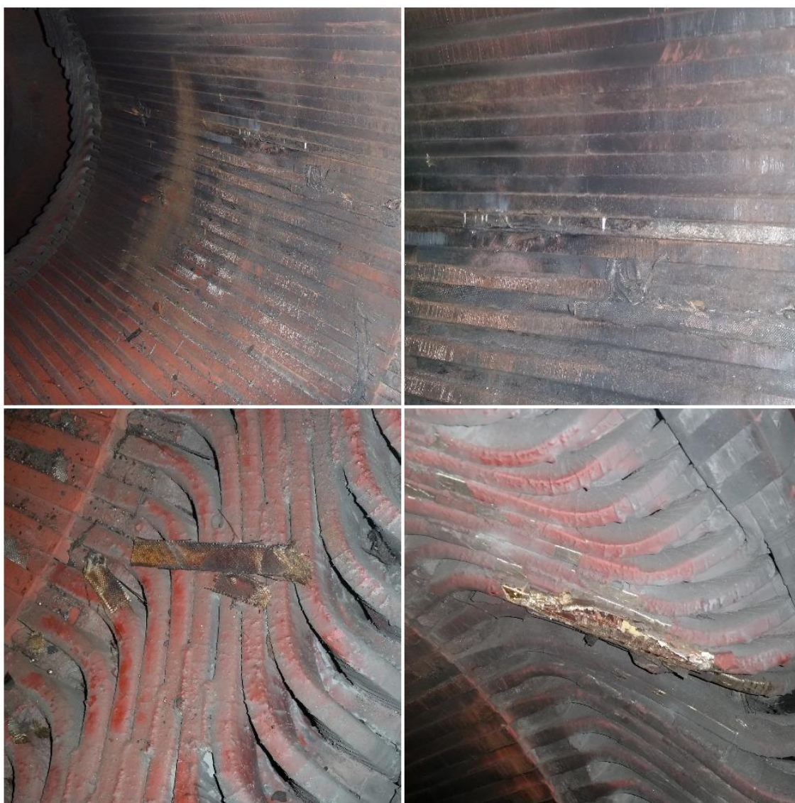
Figura A.3. Danos no estator do motor nº 1
