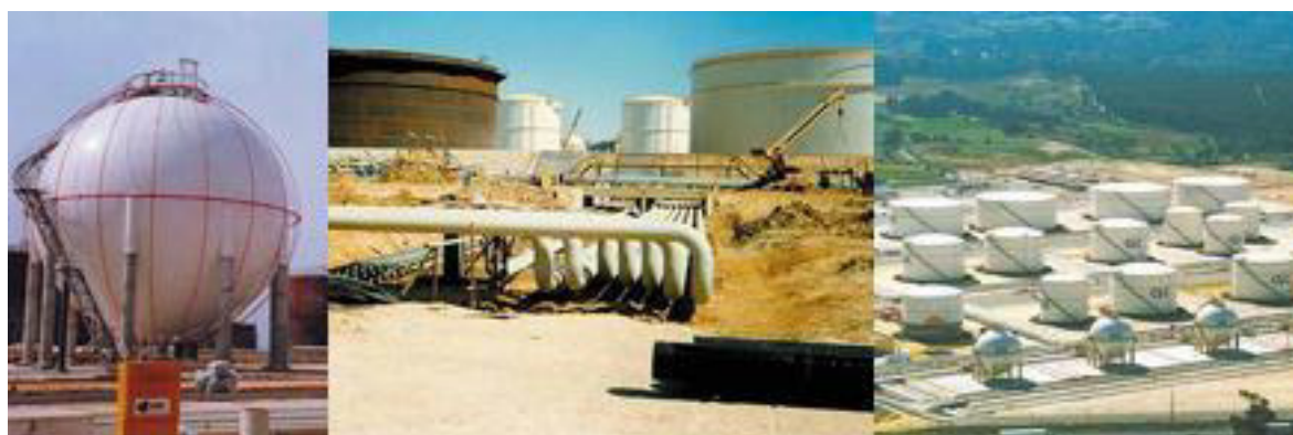
Figura 5.1 - Instalações de armazenamento de combustíveis [DGEG, 2014b].
