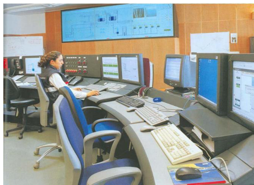
Figura 5.7 - Sala de Controlo do Edifício Técnico e Administrativo do Terminal de GNL de Sines; [DGEG, 2014c].
