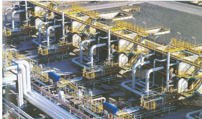
Figura 5.6 - Vaporizadores do Terminal de GNL de Sines [DGEG, 2014c].
