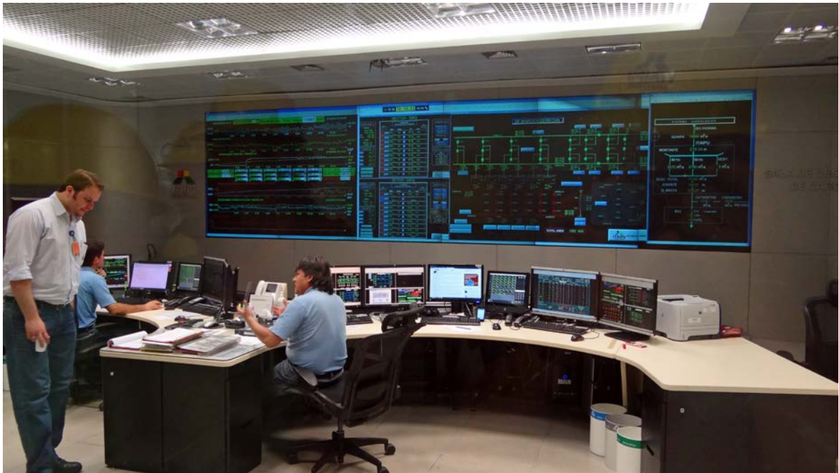
Bild 11: Kontrollzentrale (Foto: Peter Hirschmann)
