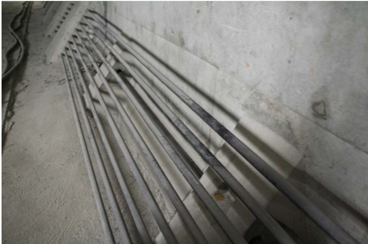
Bild 8: Extern angebrachte Vorspannkabel (Foto: Horst Werkle)
