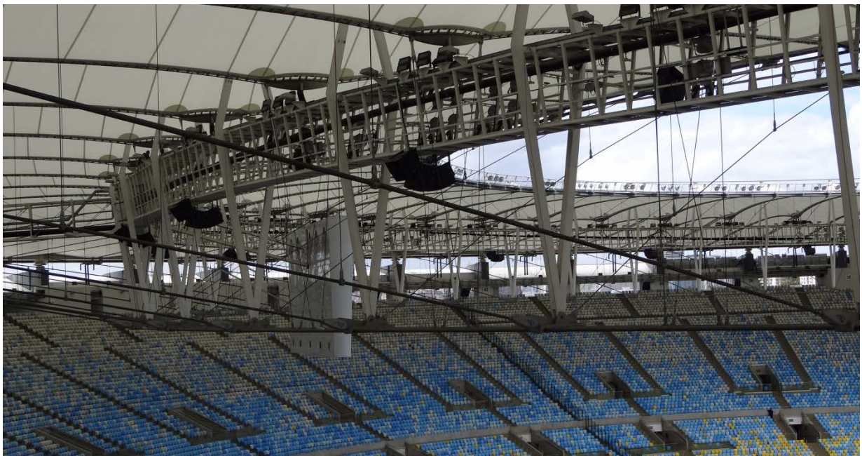
Bild 7: Das Bild zeigt die rautenförmigen Luftstützen, welche die unteren und oberen Radialeile auseinander spreizen. Gleichzeitig tragen sie den Wartungslaufsteg mit den Lautsprechern und Scheinwerfern (Foto: Peter Hirschmann)
