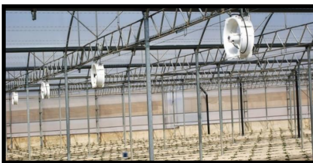
Imagen 14 (Vista del sistema de ventilación forzada)
