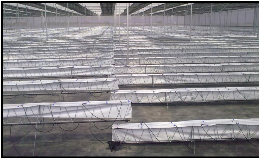
Imagen 22 (Sistema de riego)
