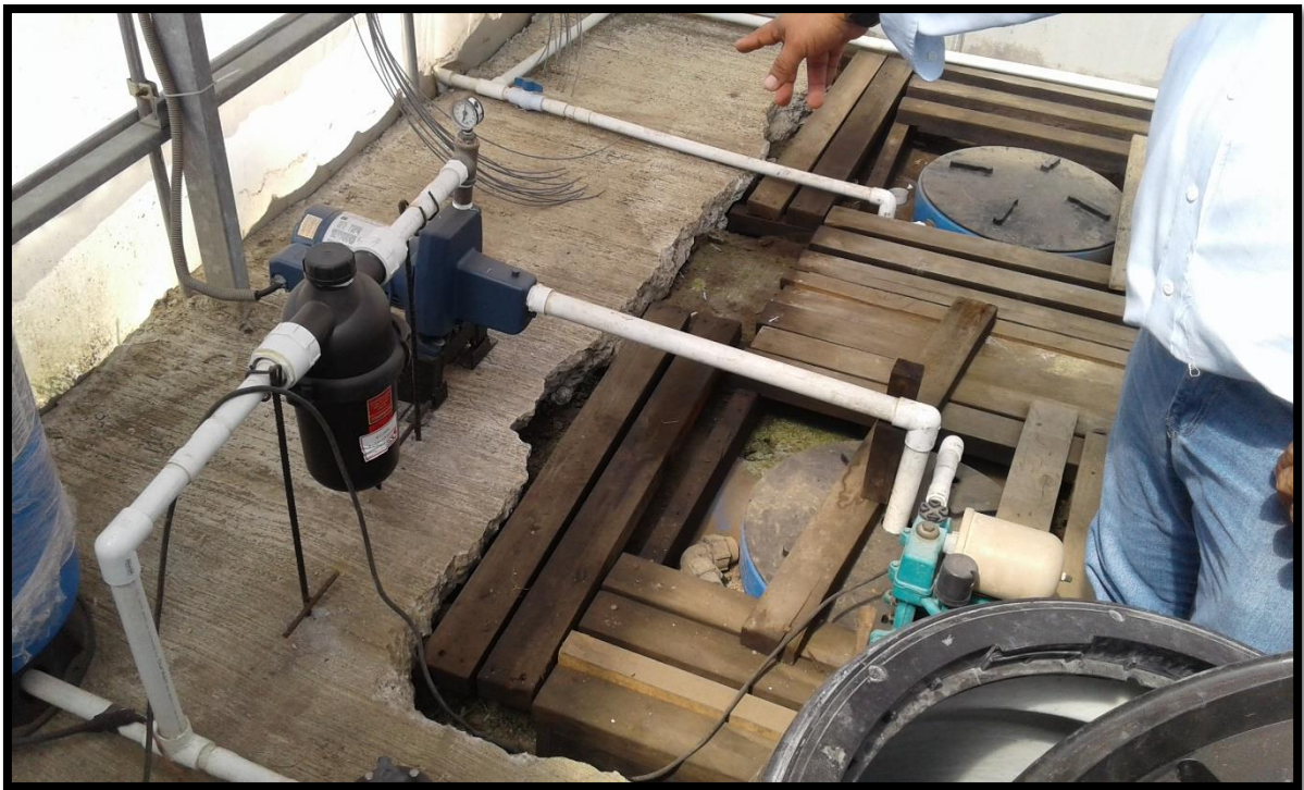
Imagen 9 (Tuberías para la Solución Nutritiva)
