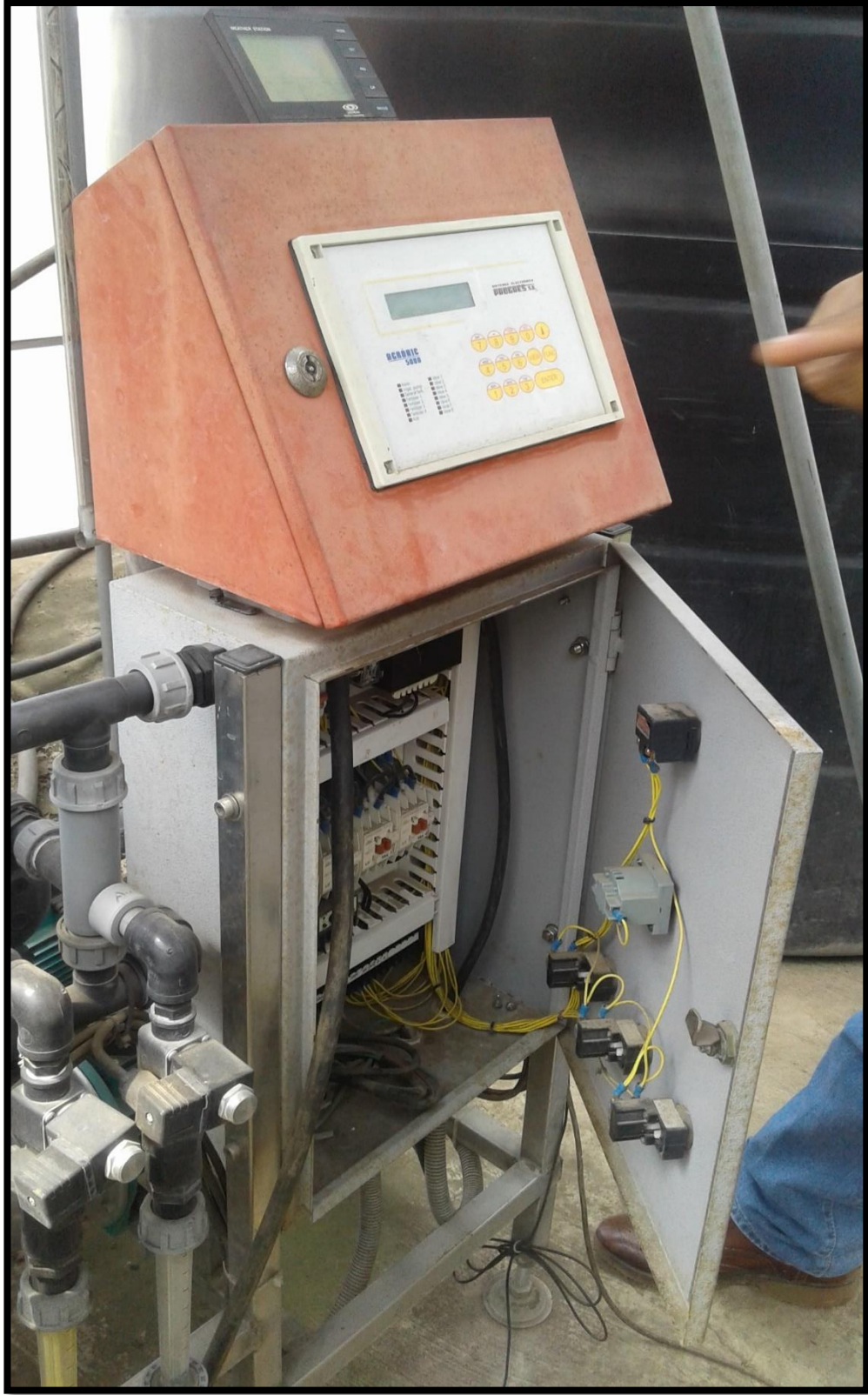
Imagen 14 (Sistema de control eléctrico en el PIPIL)
