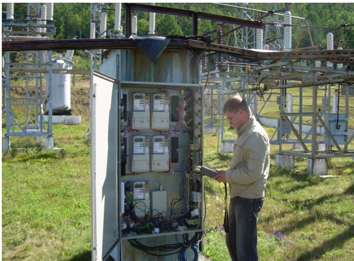
Рис. 1. Сотрудник РЦР М.В. Волков регистрирует параметры режимов работы линии 110 кВ «Бурятэнерго»
