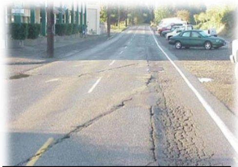
Figura 2. Fallas por agrietamiento y ahuellamiento
