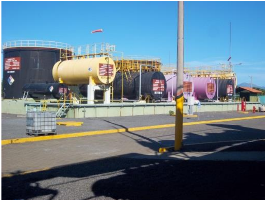
Anexos 5: Tanques de Sedimentación Fuel oil y Tanques de diesel.
