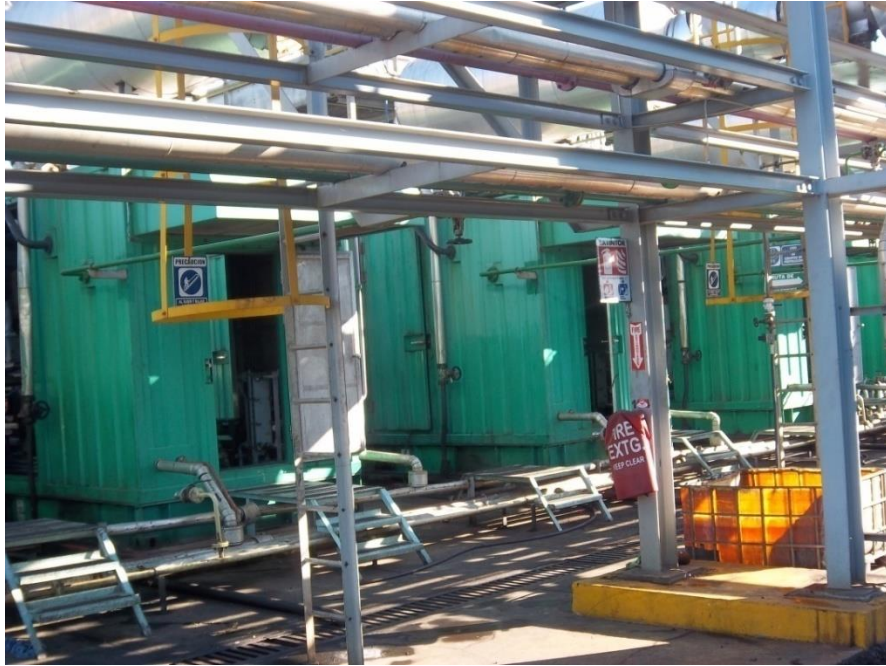
Anexos 6: área Motores Hyundai HIMSEN 9H21/32 (MDU).
