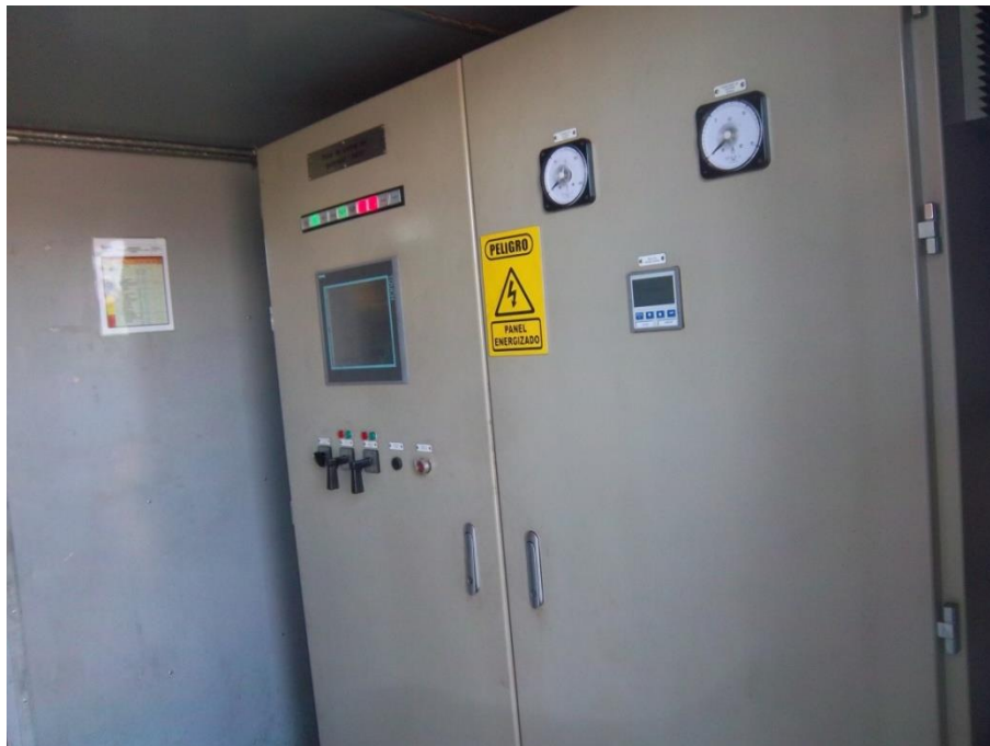
Anexos7: Panel Eléctrico de los Motores Hyundai Himsen.
