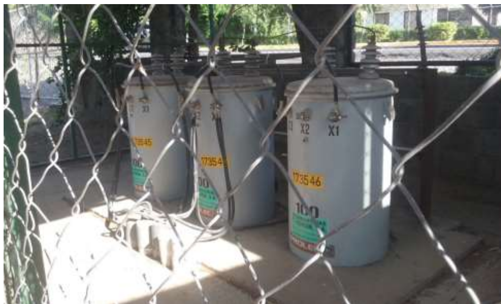
Ilustración 11, Transformadores de Nicalapia
