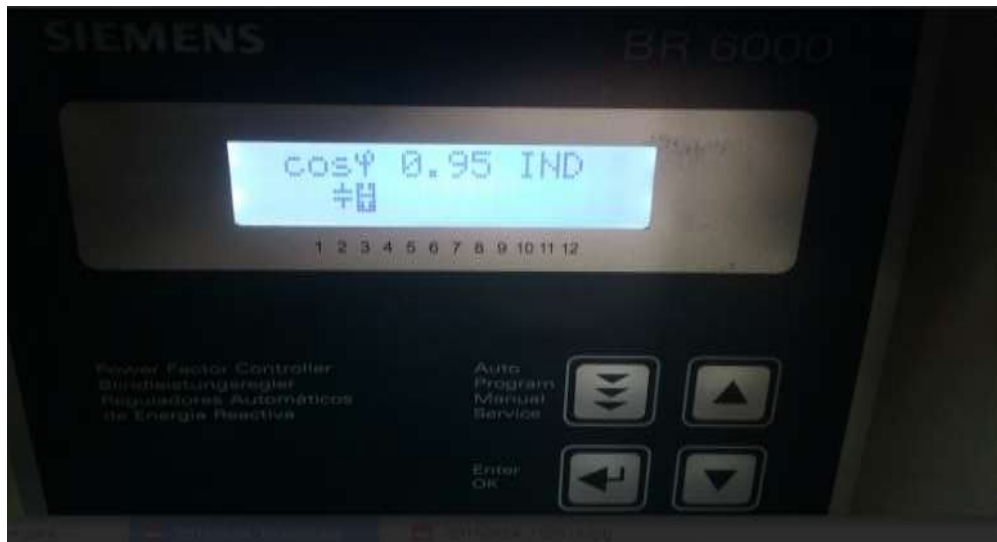
Ilustración 13, Corrección de factor de potencia en la planta
