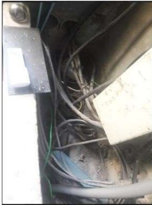
Ilustración 18, Cableado de Nicalapia
