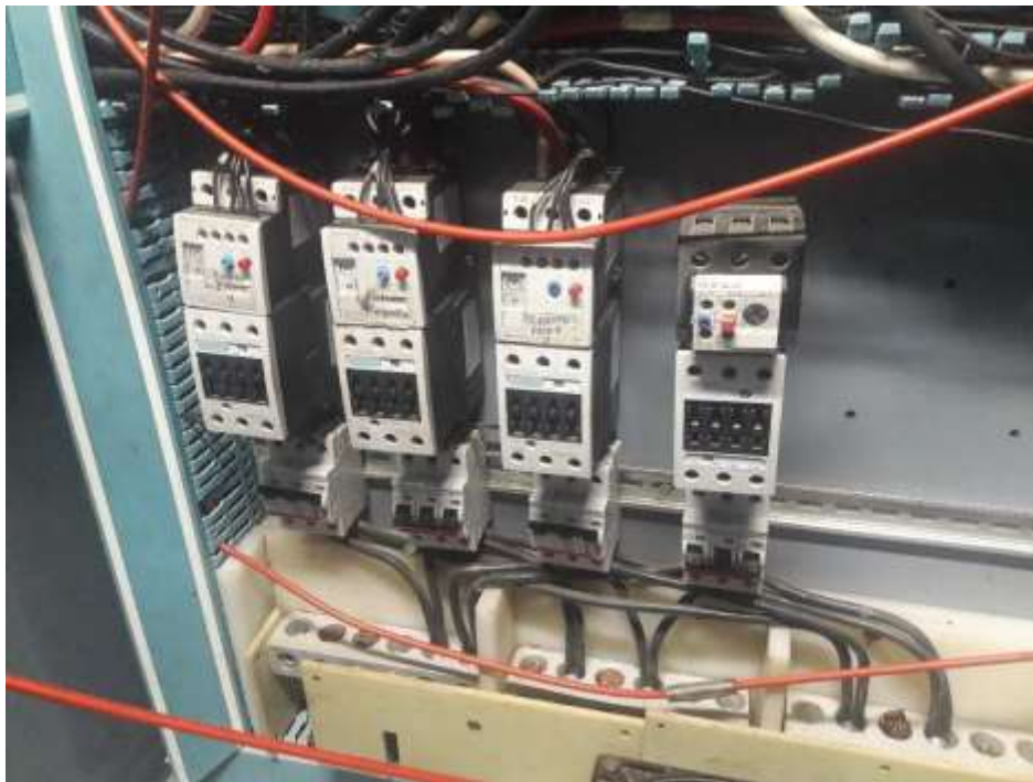
Ilustración 19, Contactores instalados en el centro de control
