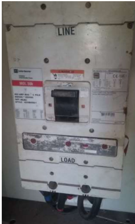
Ilustración 12, Main Breaker de 3x800A
