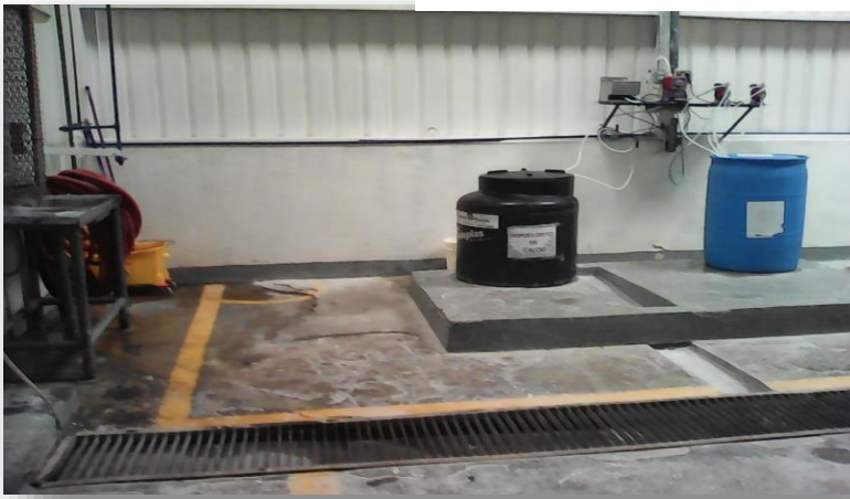
Figura 2. Pasillo tratamiento de agua
