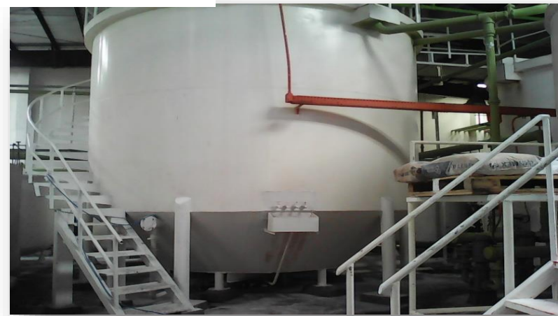
Figura 3. Tanque reactor tratamiento de agua
