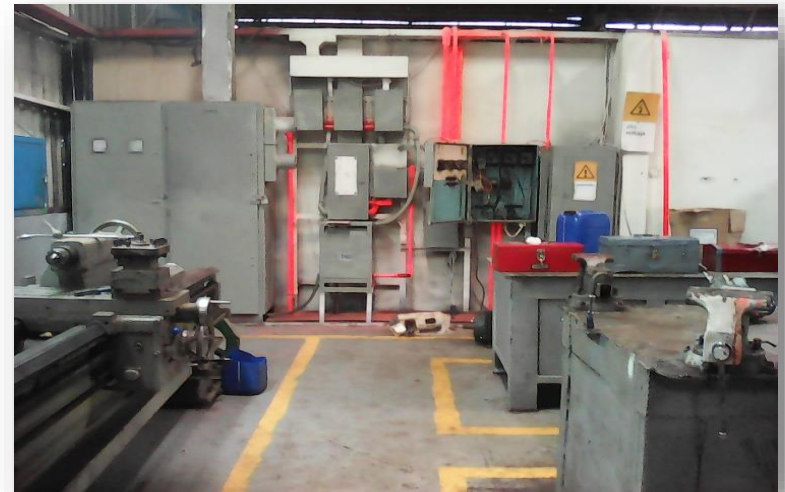
Figura 3. Paneles eléctricos taller de mantenimiento
