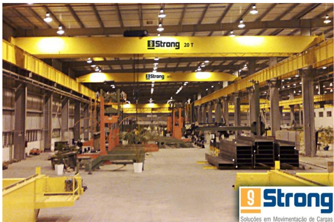
Figura 1 - Pontes rolantes univiga utilizadas para movimentação de matéria-prima
