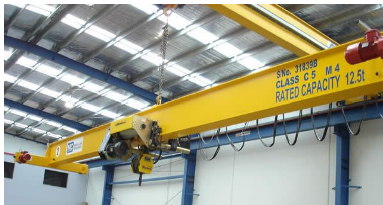
Figura 4 - Ponte rolante univiga
