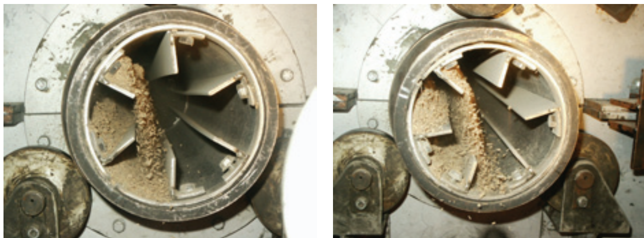
Figura 8. Dispositivo de aletas instalado en el interior del horno rotatorio.
