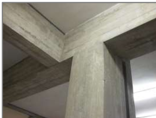
Figura 2.28: Irregolarità strutturale di un nodo
