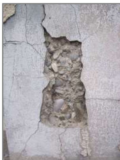
Figura 2.27: Deteriorazione di una parte di intonaco in cui si evidenzia la grossolanità degli inerti utilizzati per i getti del cemento
