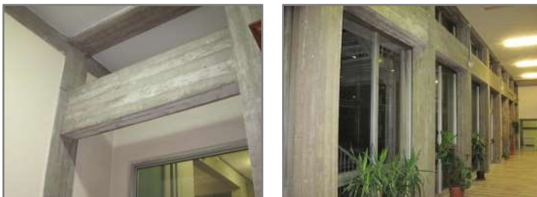
Figura 2.21: Travi non portanti presenti al piano terra interne (a sinistra) e perimetrali (a destra)
