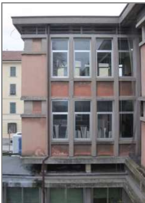
Figura 2.16: Edificio B, continuità strutturale di alcuni elementi verticali non rispettata
