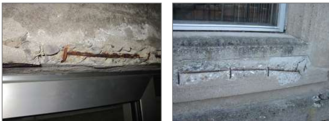
Figura 2.26: Espulsione del copriferro in alcuni elementi strutturali, con messa a nudo delle barre metalliche
