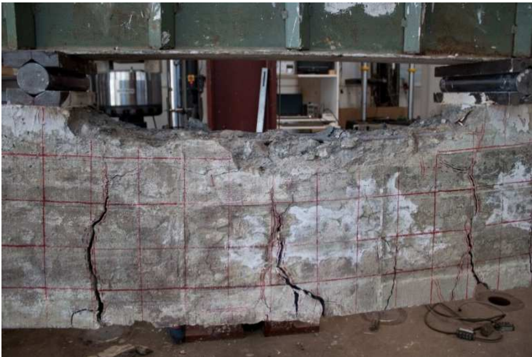
Figura 4.4 – Marcatura del quadro fessurativo
