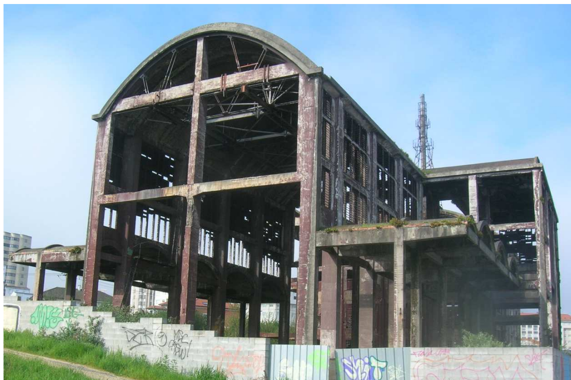
Figura 3.3 – Stato di conservazione della Fabbrica di Cros prima della ristrutturazione
