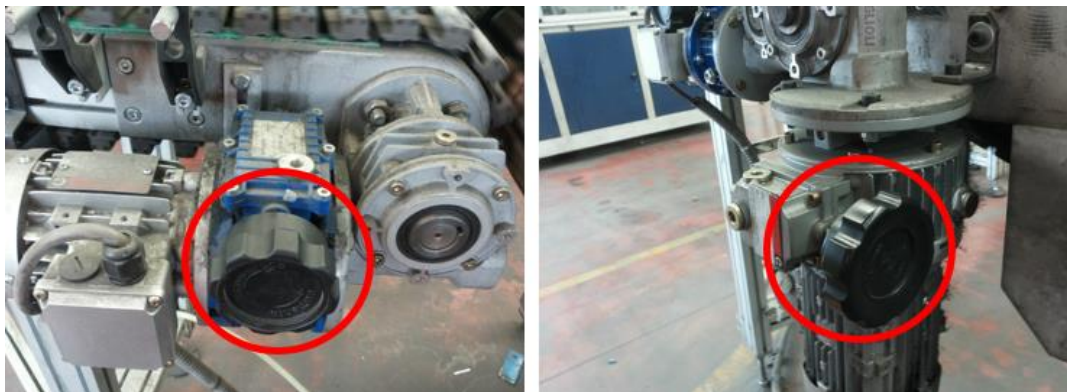
Figura 6.6: Variatori di velocità sui motori dei tappeti
