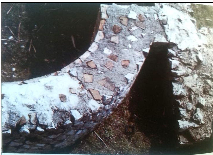
Fig.41. E' possibile notare come delle tre soluzioni differenti, adottate come "copertine" murarie, la più efficace sia quella in malta di calce. (da Marino 1993, p.142.)
