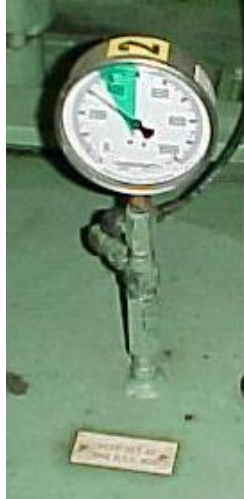
Figura 14: Controllo visivo della pressione
