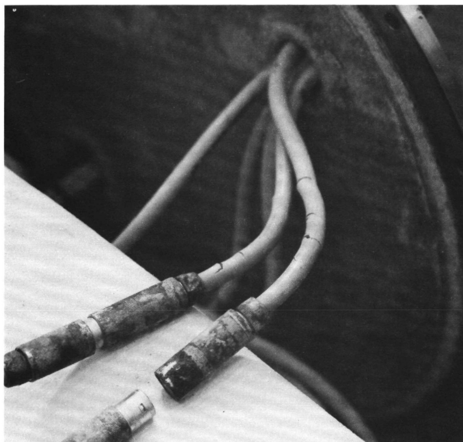
Abb. 17: Strahlengeschädigtes Meßkabel SIENOPYR FRNC X
