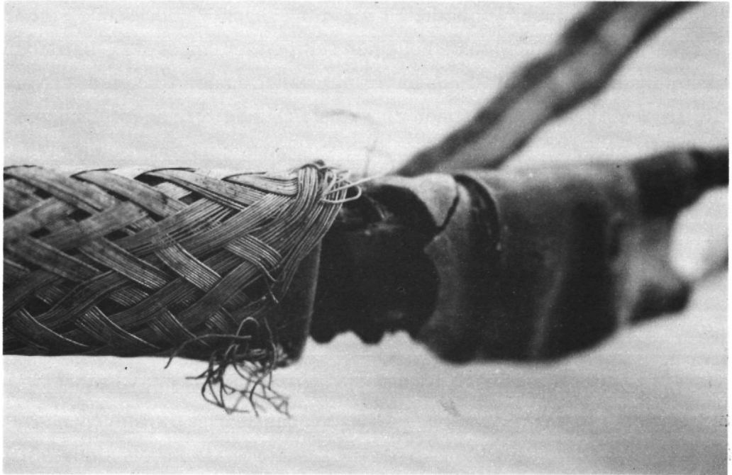
Abb. 15: Detail der strahleninduzierten Schädigung des selbstregelnden Heizbandes
