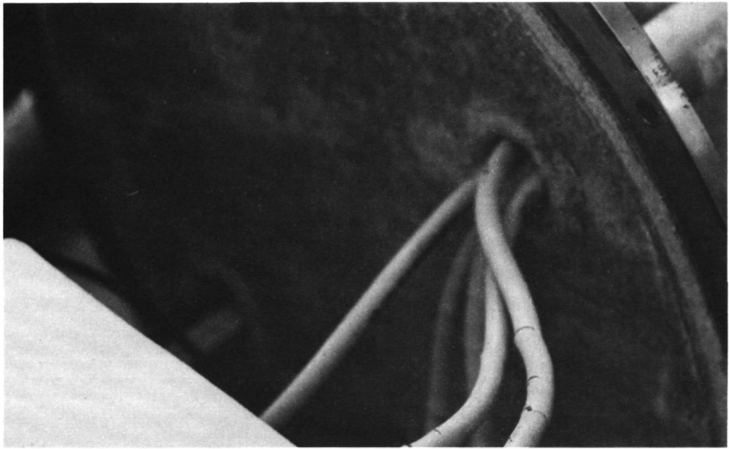
Abb. 23: Korrosionsbeläge auf dem Deckel (W.-Nr. 1.4541) nach 22-monatiger Standzeit bei 60°C
