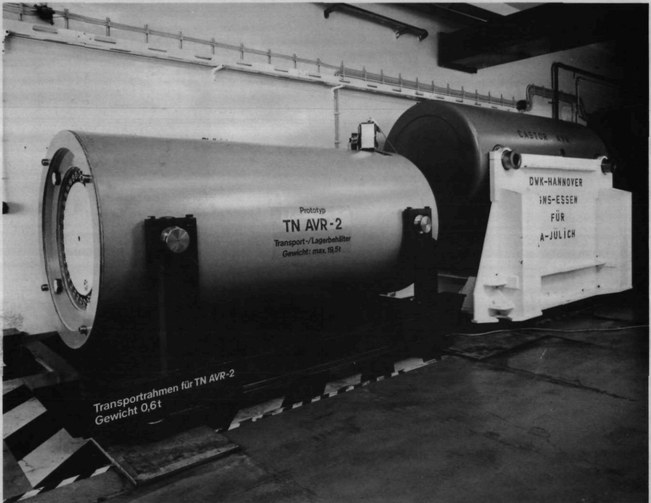
Abb. 4: Behälter TN-AVR 2 am Aufstellungsort in den Grossen Heissen Zellen
