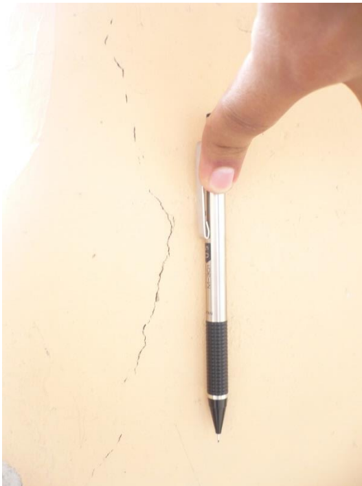
Foto 8. Fisura Longitudinal en columna -
