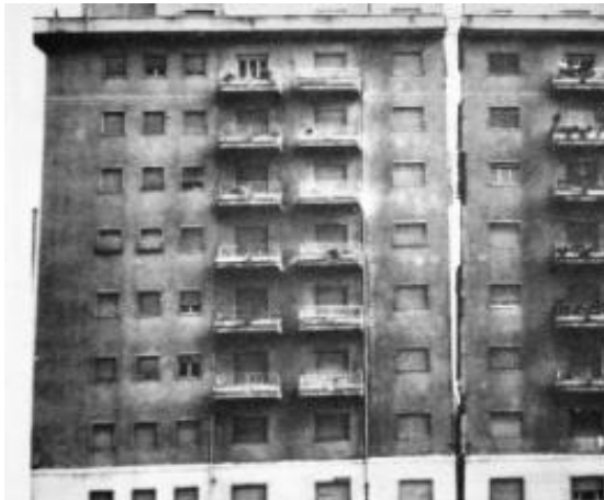
Figura 14. Desplome estructural debido a Asentamiento Diferencial
