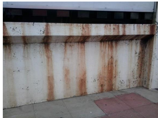
Figura 10. Ejemplo de Suciedad por Lavado Diferencial
