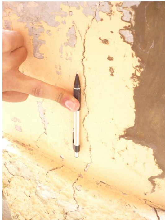
Foto 9. Grieta Longitudinal en columna C-25-
