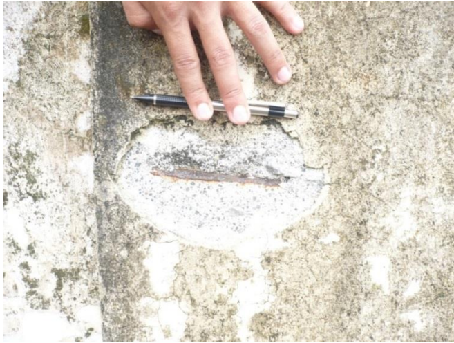
Foto 3. Desprendimiento de recubrimiento y exposición de refuerzo
