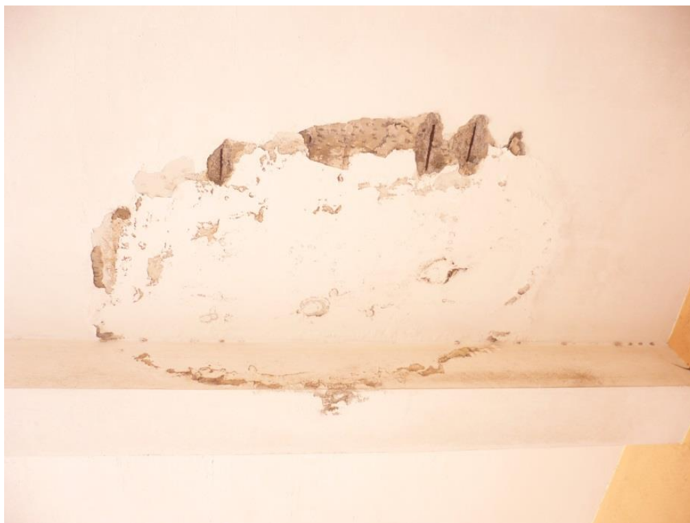
Foto 7. Desprendimiento de recubrimiento en losa de entrepiso y corrosión de refuerzos
