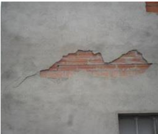
Figura 18. Desprendimiento de Mortero
