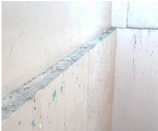
Foto 4. Ataque químico debido al excremento de aves
