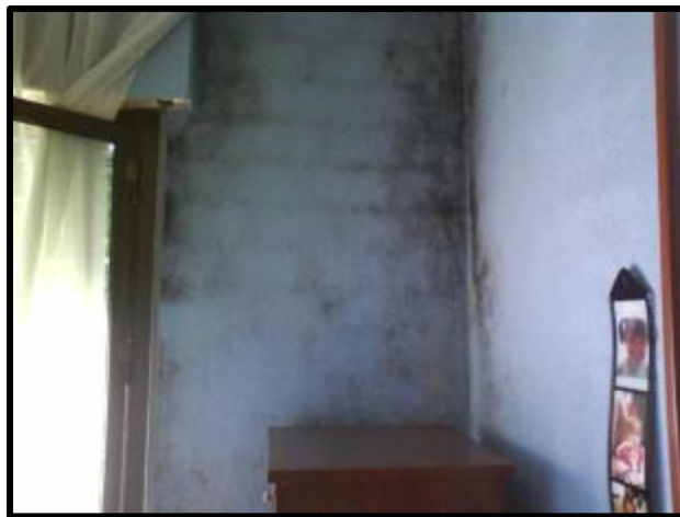
Figura 6. Ejemplo de Humedad por Condensación
