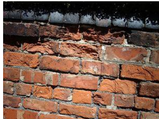
Figura 20. Ejemplo de Erosión en Ladrillo Rojo
