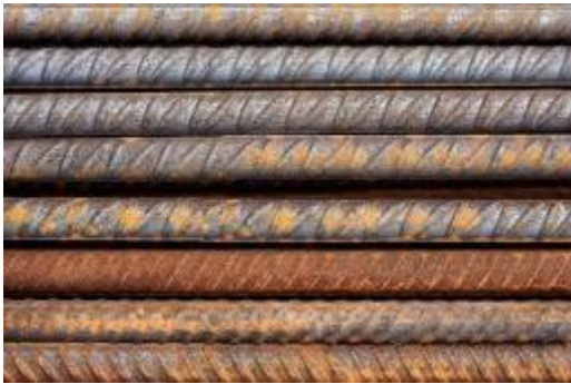
Figura 25. Oxidación en elementos de refuerzo
