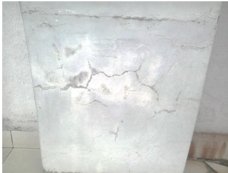
Figura 24. Aparición de eflorescencia en columna de concreto
