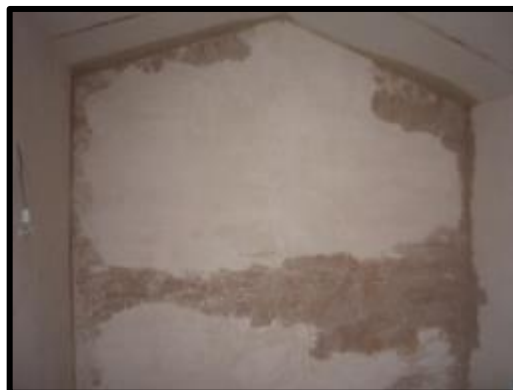
Figura 3. Pared con Presencia de Humedad de Obra
