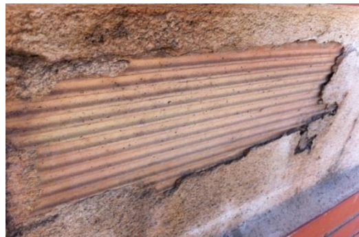
Figura 19. Ejemplo de Desprendimiento
