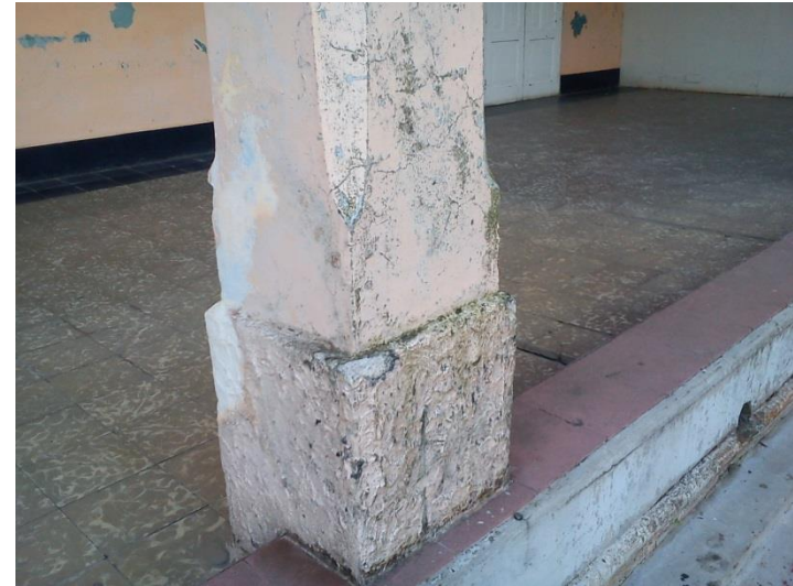
Foto 12. Desprendimiento de pintura y presencia de moho sobre la superficie del elemento (D-2).
