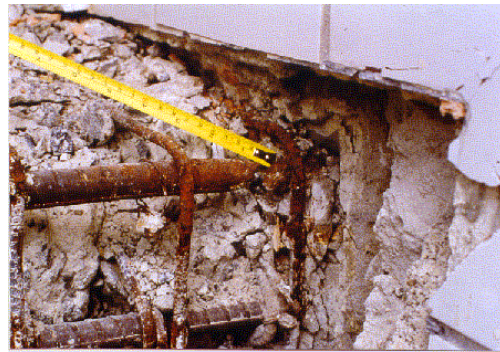
Figura 26. Corrosión en armadura de refuerzo estructural
