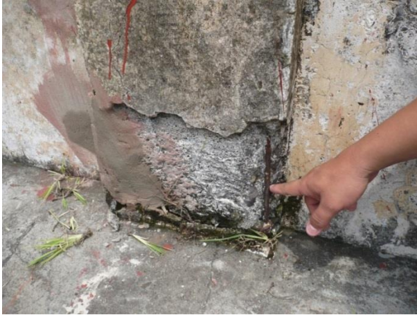
Foto 1. Desprendimiento del recubrimiento y exposición de acero de refuerzo
