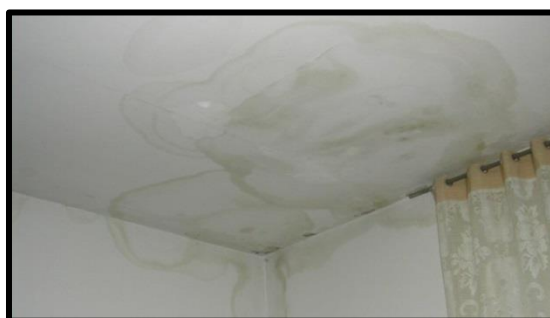
Figura 5. Ejemplo de Humedad por Filtración
