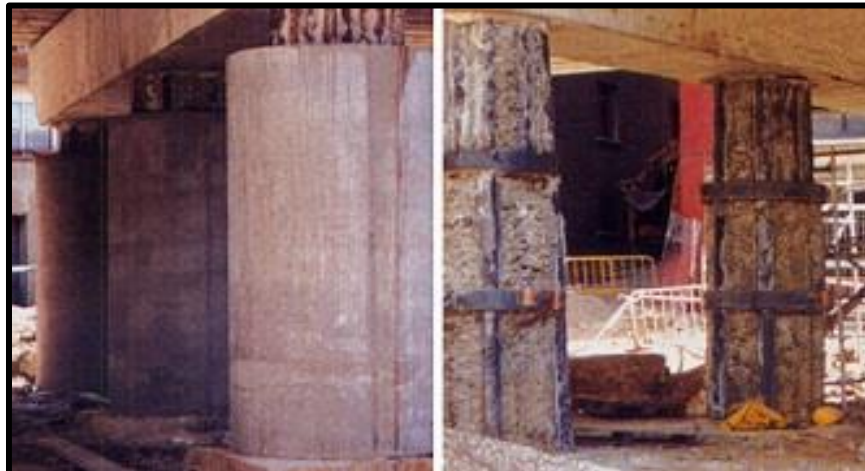
Figura 8. Columnas de Concreto antes y después de ser erosionadas
