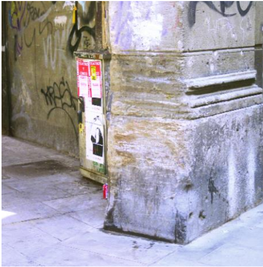
Figura 21. Erosión debido al roce permanente de vehículos y personas
