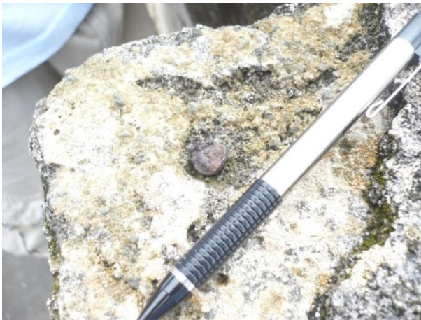
Foto 2. Exposición de refuerzo y mal confinamiento del acero de refuerzo
