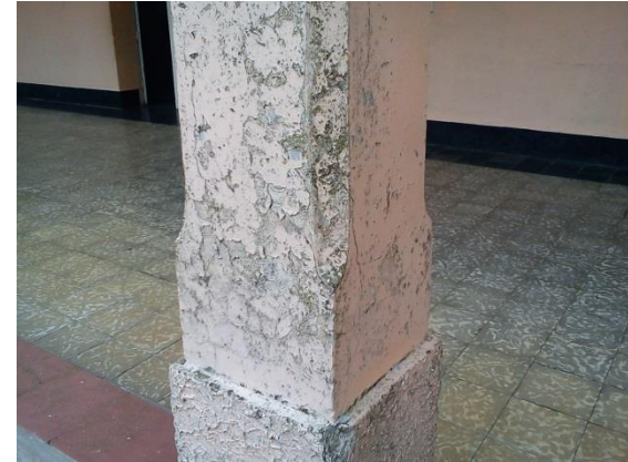
Foto 14. Perdida capa protectora de pintura (D-5)
