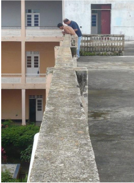
Foto 5. Desalineación de muro en azotea
