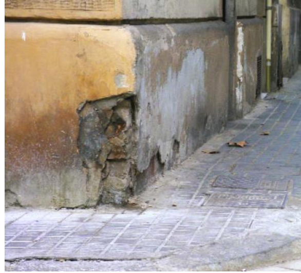
Figura 22. Erosión mecánica severa con pérdida de material constituyente
