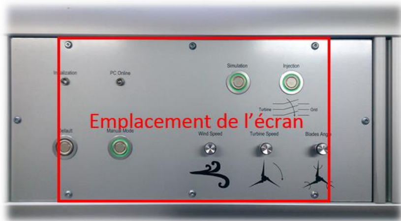
Figure 40 : Console de commande de l'éolienne
