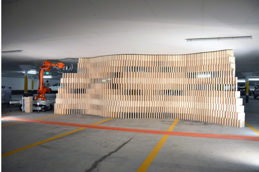
Abbildung 85: In-situ-Fabrikation der fragilen Struktur. Über 1 000 diskrete Holzelemente wurden direkt vor Ort klebefrei assembliert
