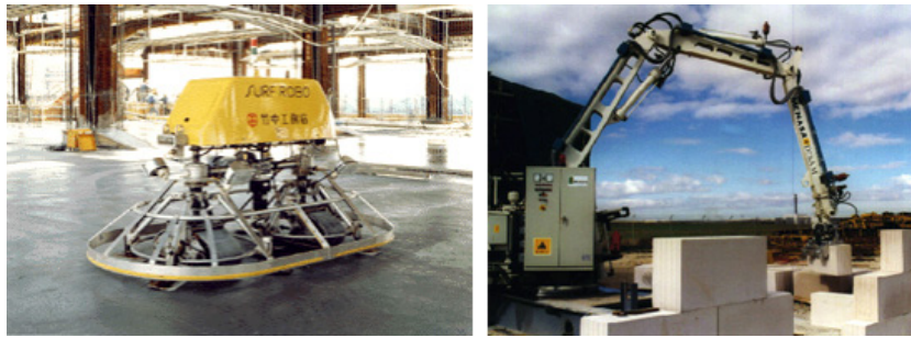
Abbildung 15: SurfRobo – mobiler Roboter für das Betonfinishing; Abbildung 16: Rocco – direkter Einsatz eines Bauroboters auf einer Baustelle
