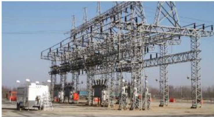
Figura 16. Localización de DPs en una subestación mediante antenas colocadas sobre una superficie móvil [20]
