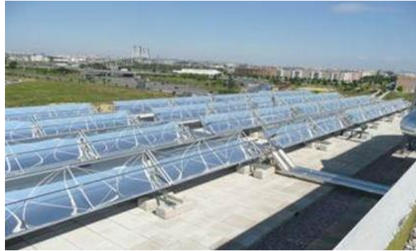
Figura 2.8. Campo solar de capacidad menor a 1 MW, instalado en azotea, de módulos tipo CCP de pequeña escala, modelo Abengoa RMT. Fuente: Abengoa Solar (Abengoa Solar, 2015)
