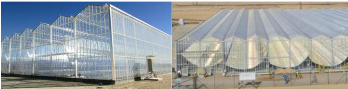
Figura 5.34. Foto de un campo solar de captador CCP de la empresa GlassPoint Solar en el sur de Omán. Fuente: GlassPoint.
