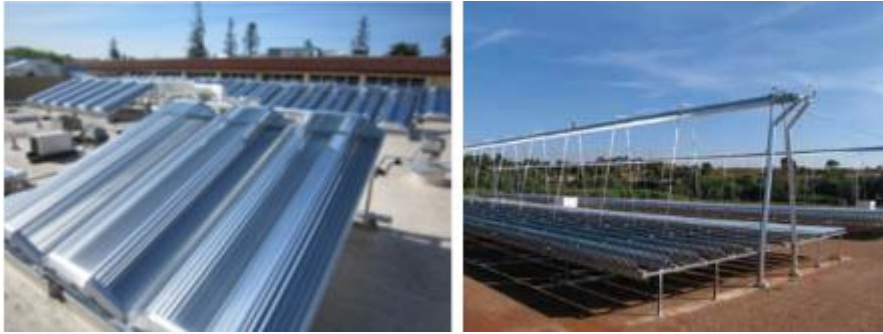
Figura 5.13. Módulos Chromasun en azotea (izq.) e instalación módulos Aira Solar en planta cárnica en Sant Joan de Vilatorrada.
