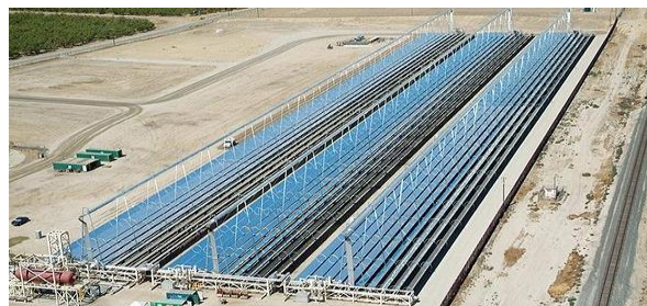
Figura 3.6. Lazos dispuestos en paralelo en la planta solar térmica Kimberlina, en Bakersfield, California. Fuente: (Areva Solar).
