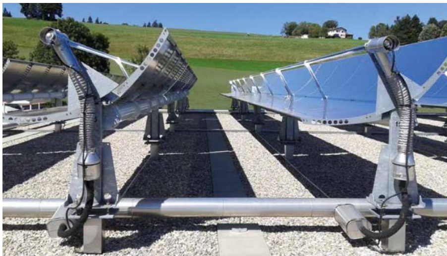
Figura 3.26. Estructura tubo de torsión en pequeña escala, colector Polytrough. Fuente: (Nep Solar)
