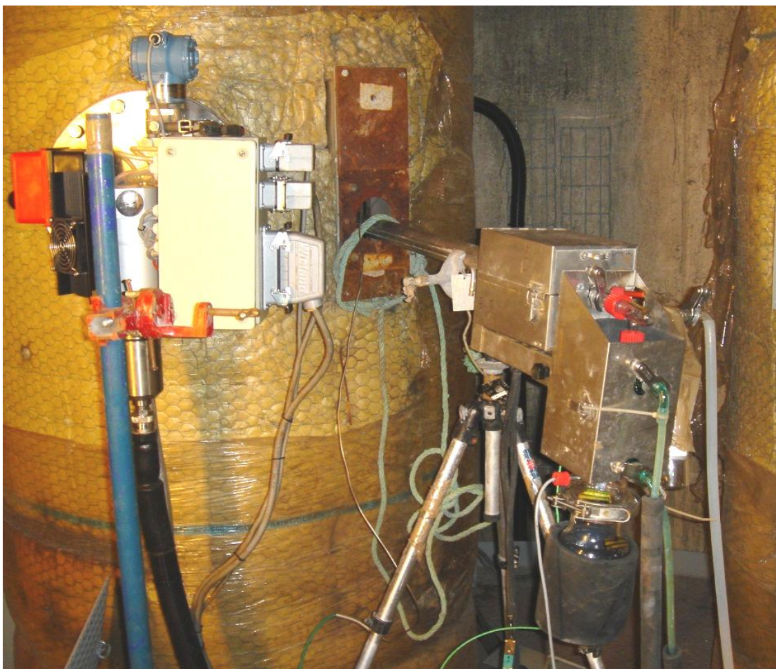
Fig. 2.8 Mostreig en paral·lel, amb la Unitat de mostreig del captador en continu – mètode de dilució- (esquerra) i el tren de mostreig manual –mètode filtre-condensador- (dreta)
