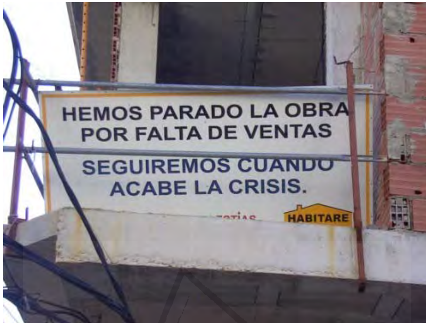
Foto 37. Cartel de obra parada. Catral, 2012
