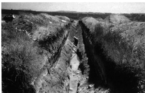
Figura 3: zanjas de desagüe efectuadas en la laguna «de Santiago», cerca de Moriles. Fuente: Junta de Andalucía.
