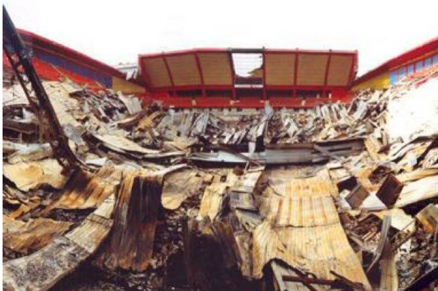
Fig. 6 Estado Tras Incendio-Fuente: http://www.synthesisfireexpert.com/investigaciones-destacadas/palacio-de-deportes-jorge-juan-de-madrid.html
