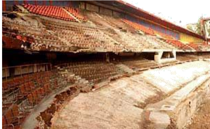
Fig. 7 Graderío Posterior al Incendiado
