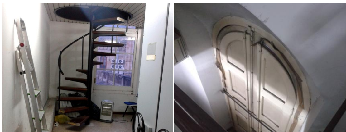
Fig. 168 i 169. Escala de cargol que connecta els dos pisos del dipòsit i, al fons, la finestra sense porticons; finestra amb els porticons tancats. Té parts segellades amb cinta adhesiva. Font: Autora.
