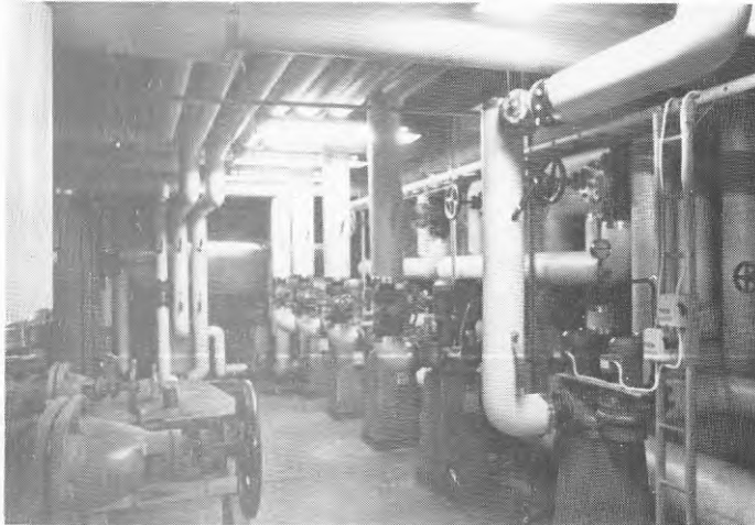
Figur 1.4. Foto av pumpgrupper.
