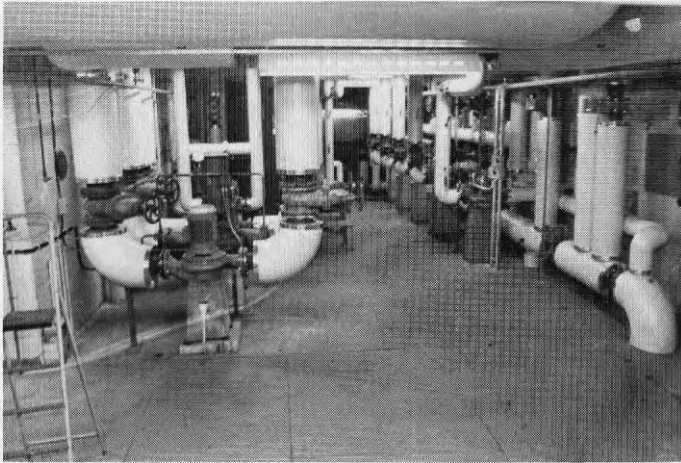
Vy över pump- och shuntgrupper i panncentral.
