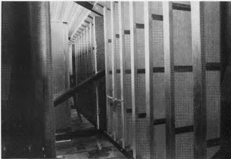
Ljudbafflarnas placering utanför luftkylbatterierna
