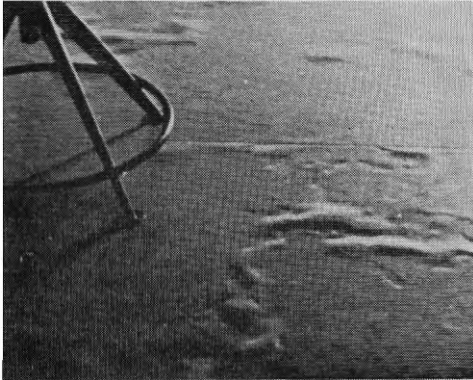
Fig. 1 Skador på PVC-matta
