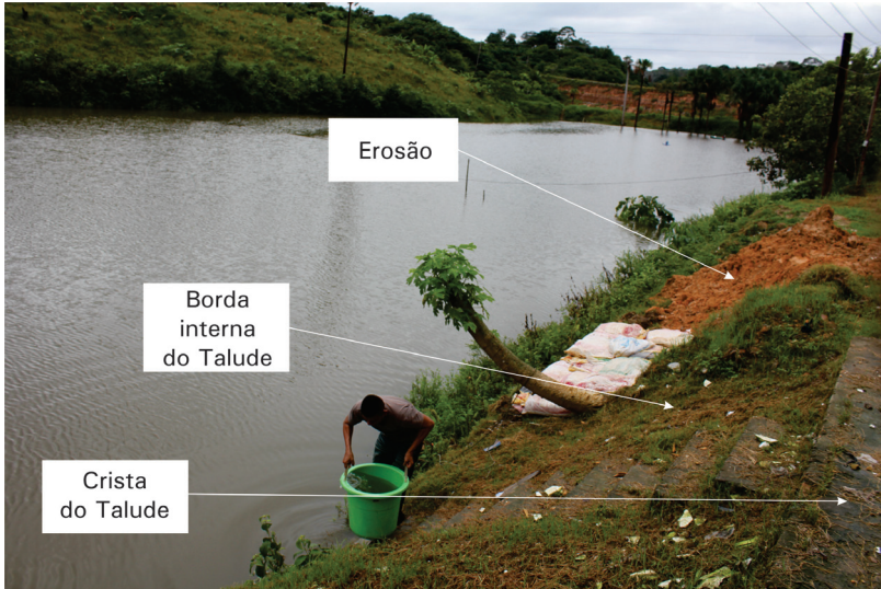
Figura 5. Erosão da borda interna do talude em viveiro de cultivo (Foto: Joel Alves).
