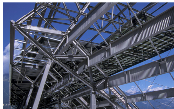
(b) madres (de 16 m) da estrutura da cobertura do estádio de Innsbruck, Áustria
